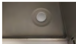
Bonde d'évacuation des eaux de nettoyage
